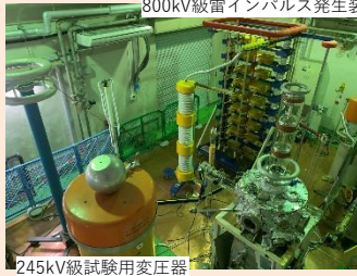
245kV級試験用変圧器
