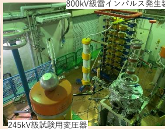
800kV級インパルス発生装置
