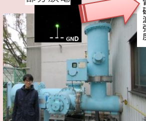
154 kV級ガス絶縁開閉装置(GIS)
